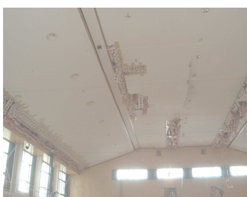
天井パネルの落下状況
