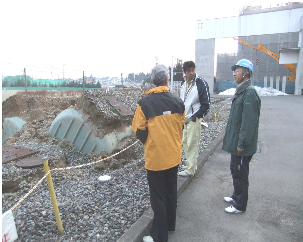
液状化によって盛り上げられた市総合体育館・浄化槽
