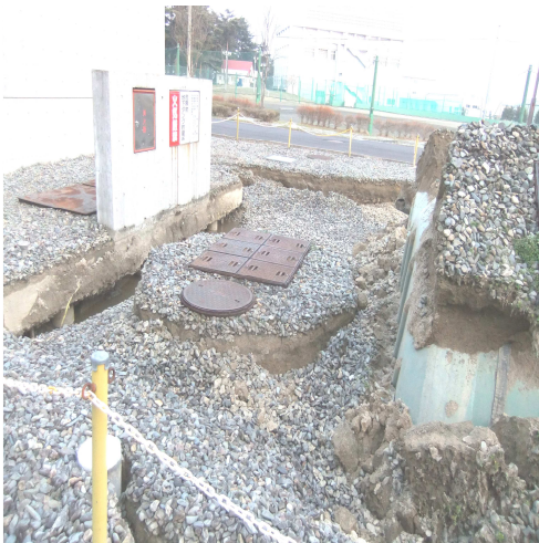
汚物タンクと浮いた浄化槽
