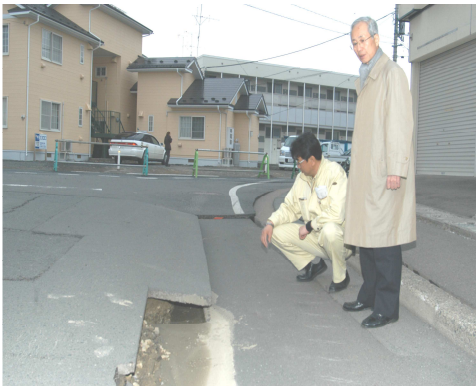
大きな段差ができた市道
